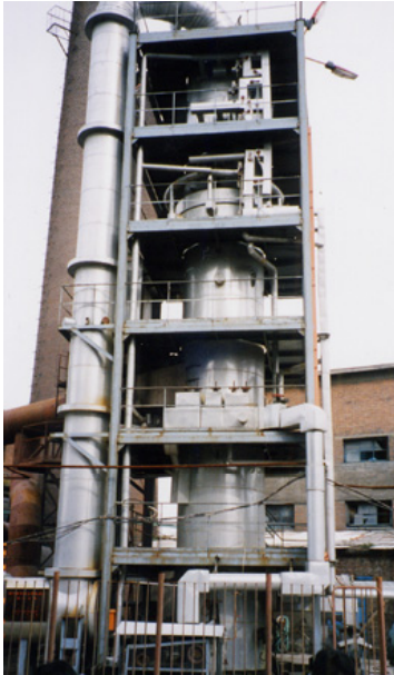
Fig. 2 低コストの水膜式脱硫装置 98%以上の脱硫率（3号機を建設中）
